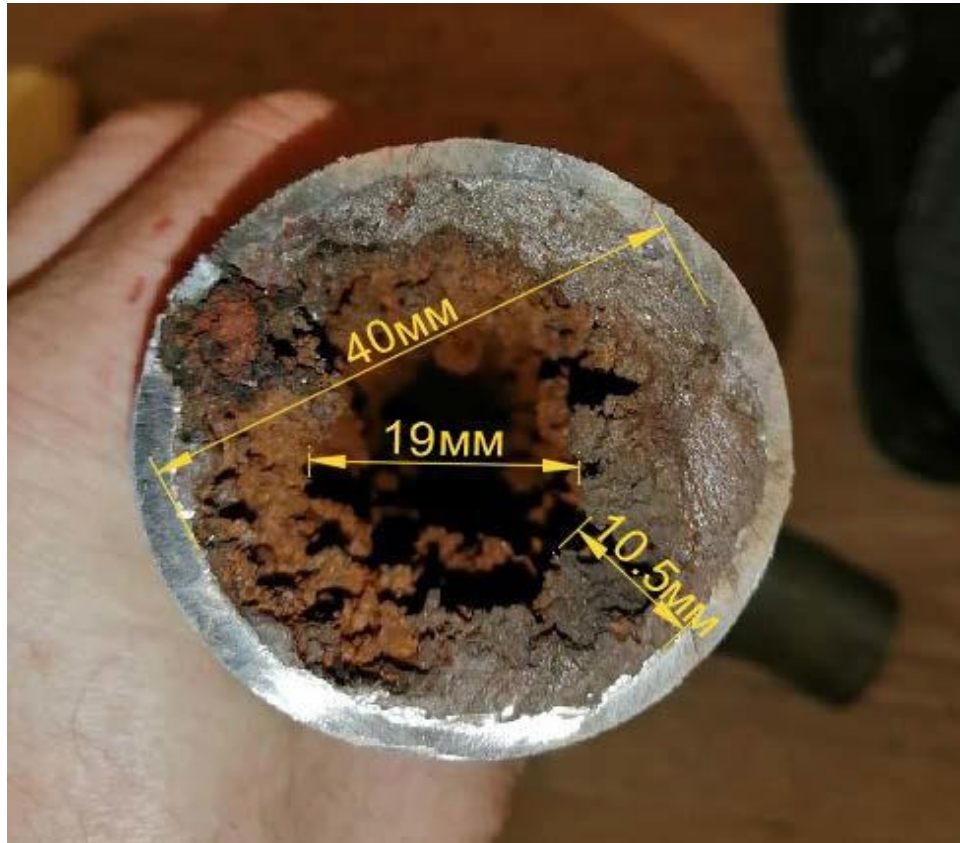
Коррозионные отложения оцинкованного стального трубопровода
