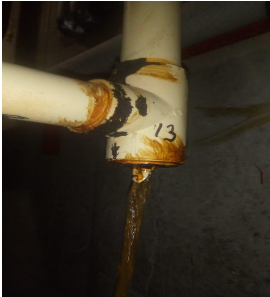
Пример разрушения ХПВХ трубопровода
