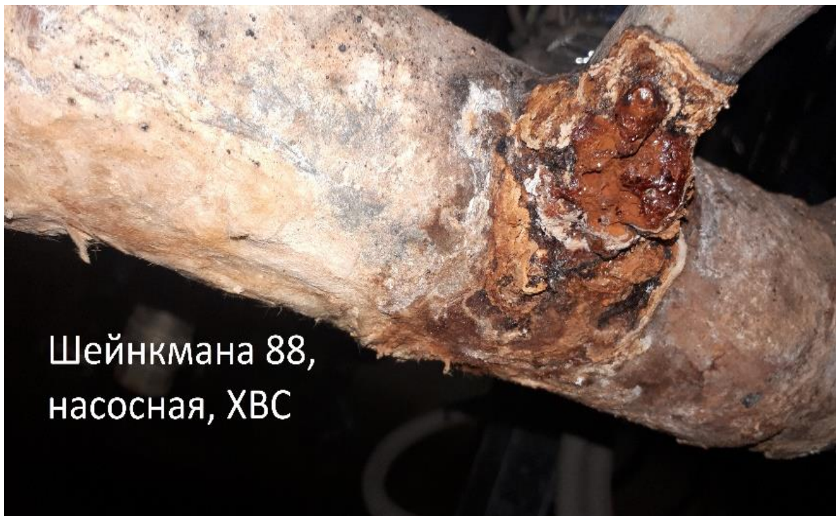
Коррозия сварного шва оцинкованного стального трубопровода
