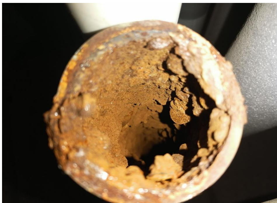
Коррозионные отложения оцинкованного стального трубопровода
